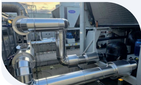
POMPES À CHALEUR
