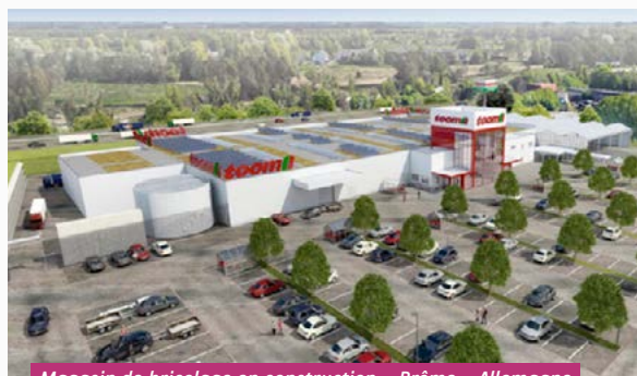
Magasin de bricolage en construction - Brême - Allemagne Livraison prévue au 3 ème trimestre 2023
