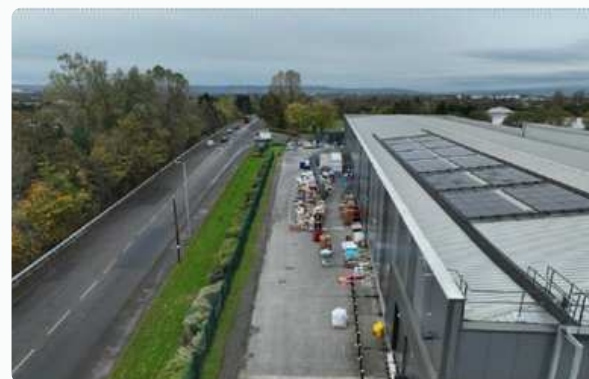
Panneaux photovoltaïques sur l'actif situé à Glasgow.
